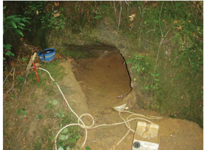
Une belle conduite forcée à décolmater
